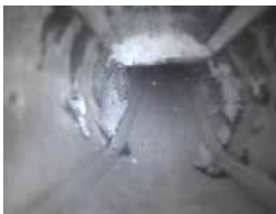
地すべりによるガイドパイプの変状
